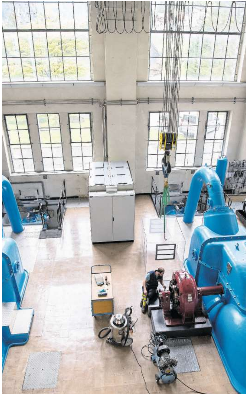
Blick ins Elektrizitätswerk Obermatt. Das EW Obwalden wird die vier dortigen Angestellten im Auftrag der neuen AG übernehmen. Bild: Nadia Schärli (Grafenort, 8. Mai 2019)
