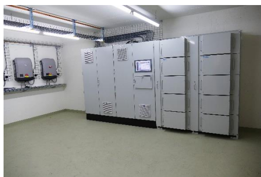
Batteriespeicher im Unterwerk Sarnen
